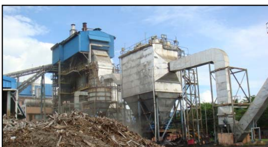
バイオマス発電所近景
